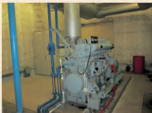
更新前の非常用発電機(昭和 61 年設置)
