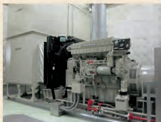
新しい非常用発電機
