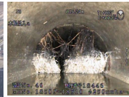
管渠への侵入根
