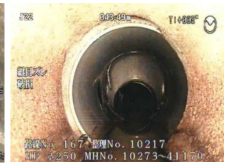
管渠の継手ズレ
