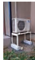
⑤屋外設備機器 かさ上げ
