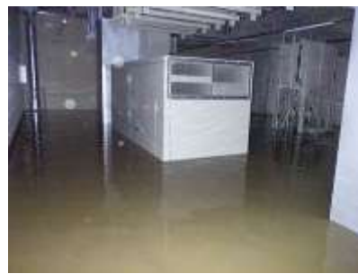
浸水した非常用発電機
