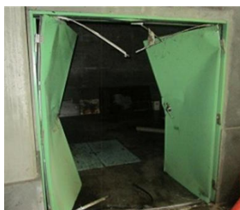
【河原子中継ポンプ場】
