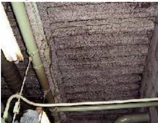
【石綿含有吹付けロックウール】
