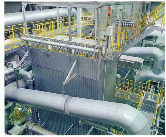
C 集じん器 排ガス中のばいじんや塩化水素などの有害物質を効率的に取り除きます。
