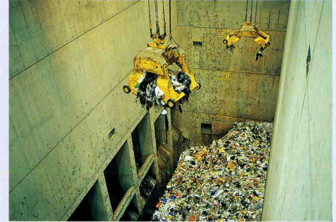
⑧ごみクレーン・ごみピット ごみピットに貯留されたごみは、ごみクレーンで炉内に投入されます。
