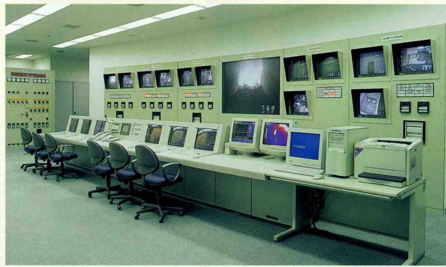
⑤中央制御室 焼却炉、灰溶融炉の運転操作及び監視をここで集中して行います。
