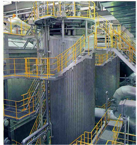
B ガス冷却塔 ボイラで熱回収した後の排ガスを、排ガス処理に最適な温度まで冷却します。
