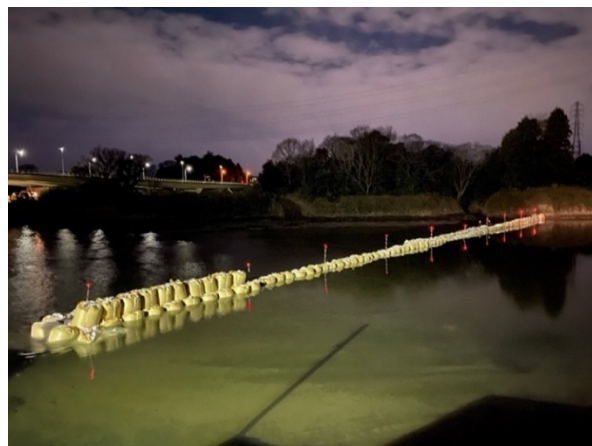
海水遡上対策として設置した土堰堤(久慈川取水場付近)
