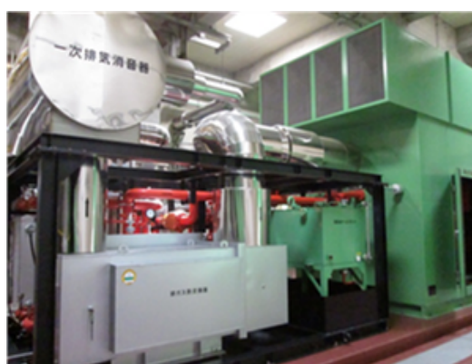
消化ガス発電機
