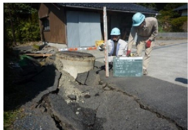
地震による被害(マンホール浮上)
