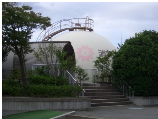
消化ガスタンク
