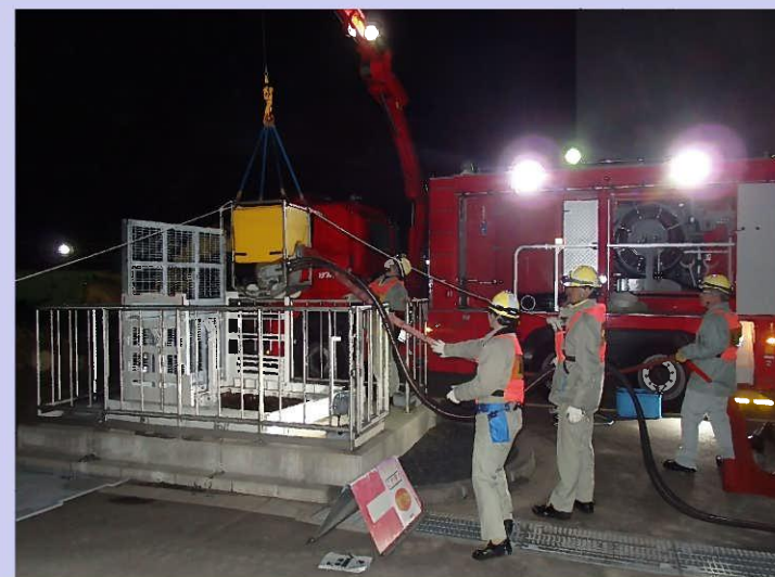
暗所環境下での可搬型代替注水ポンプ車の設置・運用
