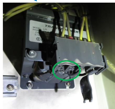
写真3 変圧器拡大写真
