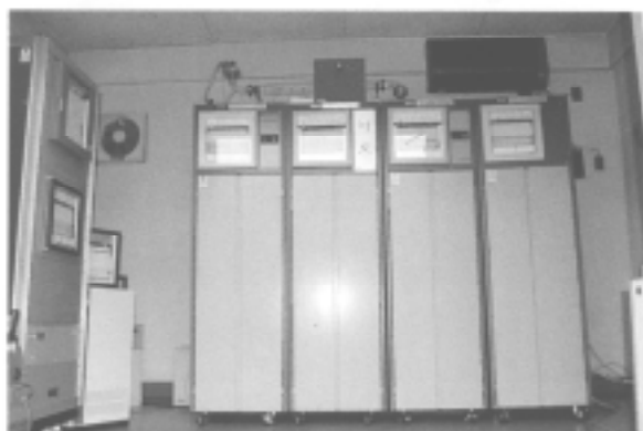
測定局舎内部の自動測定機
