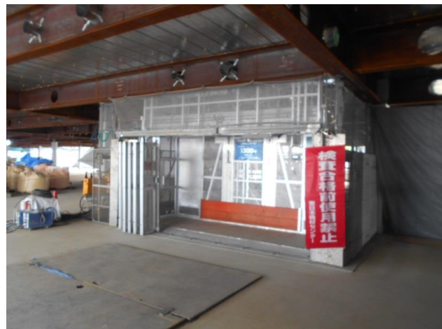
■仮設エレベーターの設置 工事に必要な資材などを運搬するため、仮設のエレベーターを設置しました。一度に重さ1,300kgまでの荷物を運ぶことができます。
