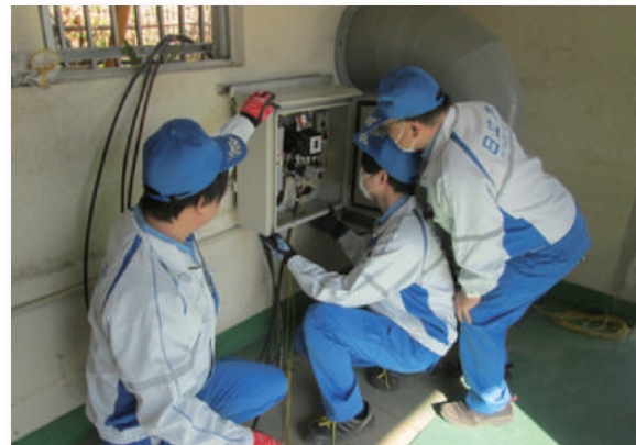
仮設制御盤設置訓練(会瀬ポンプ場)
