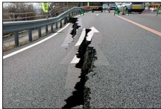
▲道路の損壊（国道245号）
