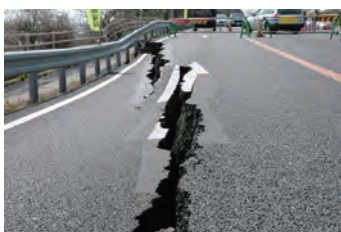
道路の損壊(国道245号)
